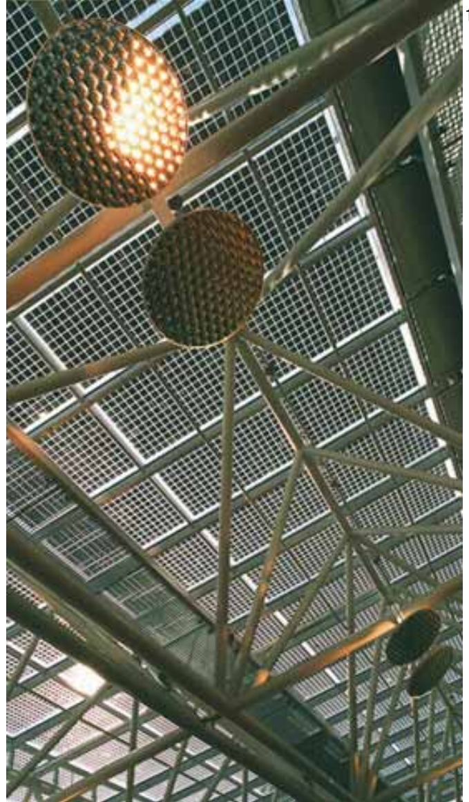
Abbildung 32: Einkaufszentrum in Zürich. Glasdach der Vorhalle mit Isolierglas-integrierter Solaranlage in Zürich. Die Installation ist Teil der Vorhalle zum Einkaufszentrum Limmat. In die horizontal montierten Wärmeschutzgläser sind Solarzellen integriert, wodurch weitere Aufbauten entfallen. Gleichsam dient sie als Reflektor für die indirekte Innenbeleuchtung. Die Photovoltaikanlage mit 30 kW Leistung liefert ihren Strom an die Solarstrombörse des Elektrizitätswerks der Stadt Zürich (ewz). Quelle: energiebüro Zürich
