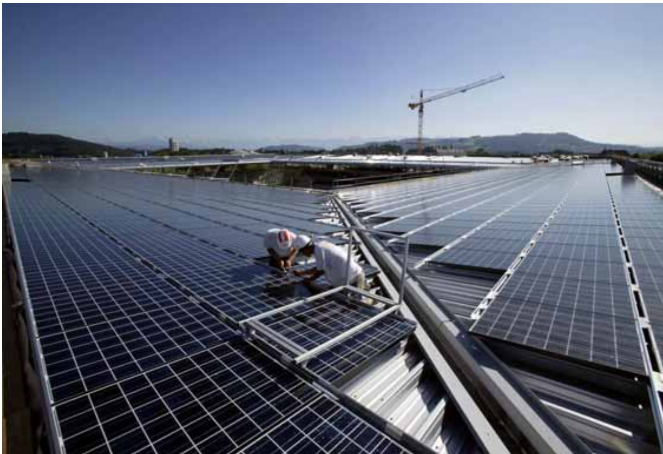
Abbildung 25: Stade de Suisse in Bern . Die Solaranlage ist im Mai 2005 als weltgrößte stadion-integrierte Solarstromanlage eingeweiht worden. Sie deckt auf Jahresbasis den Strombedarf von 200 Schweizer Haushalten. Quelle: BKW
