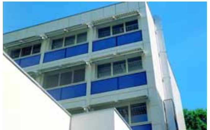
Abbildung 34: Verwaltungsgebäude der Gastro Ticino in Lugano mit photovoltaischen Beschattungselementen. Die Solarzellen sind auf beweglichen Platten montiert. Die automatisch gesteuerte Ausrichtung gewährleistet zwei Funktionen: Wirkung als Sonnenblenden auf den Fensterflächen und energieertragsoptimale Orientierung der Zellen. Die Fassade weist auch Solarkollektoren (in blau) auf. Quelle: B. Gerber, SSES, Bern
